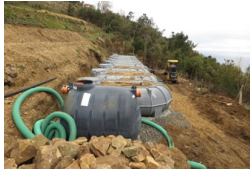
RECUPERO ACQUA PIOVANA
